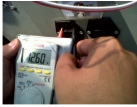
Gambar 23. Pengukuran Tegangan Output pada Accumulator
